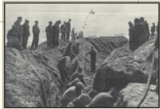
Operación de echar el cable a tierra para conducirlo por una zanja hasta la caseta de amarre.
